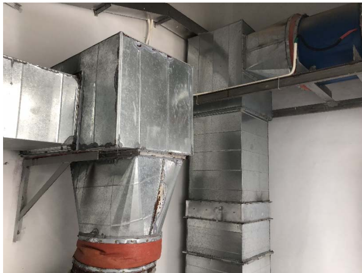
图 5-9 风机房排风管道
