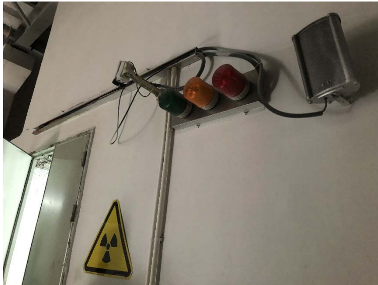
图 5-6 加速器室安全门边的电离辐射警示标志和警示灯
