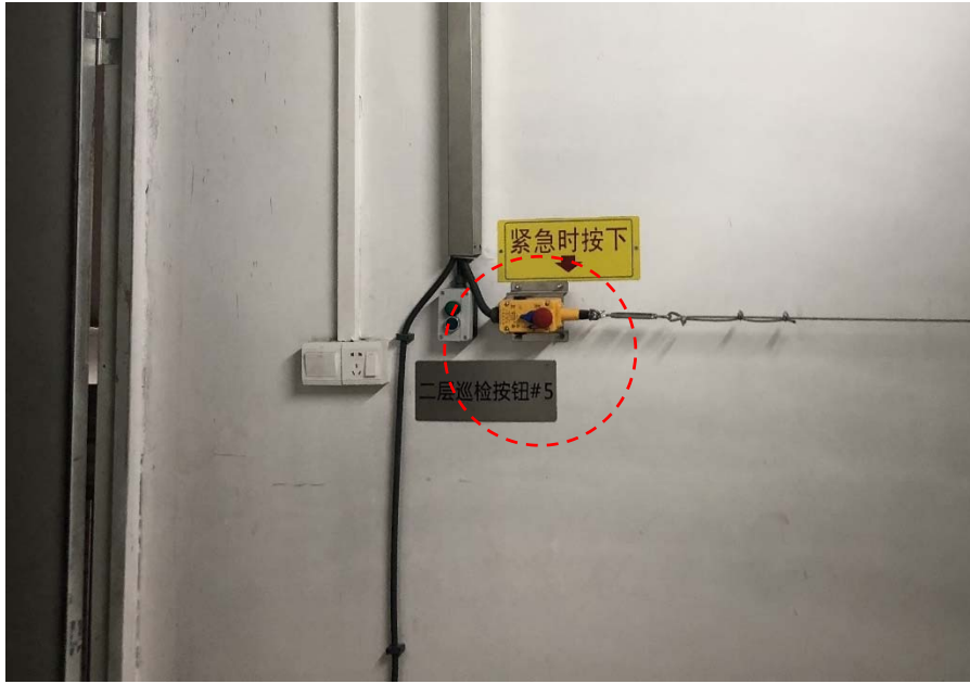
图 5-3 二层加速器室安全门入口墙上的急停按钮
