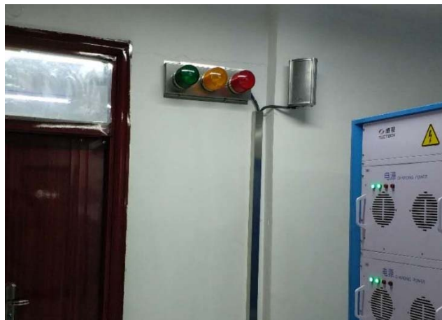
图 5-4 二层设备间的警示灯
